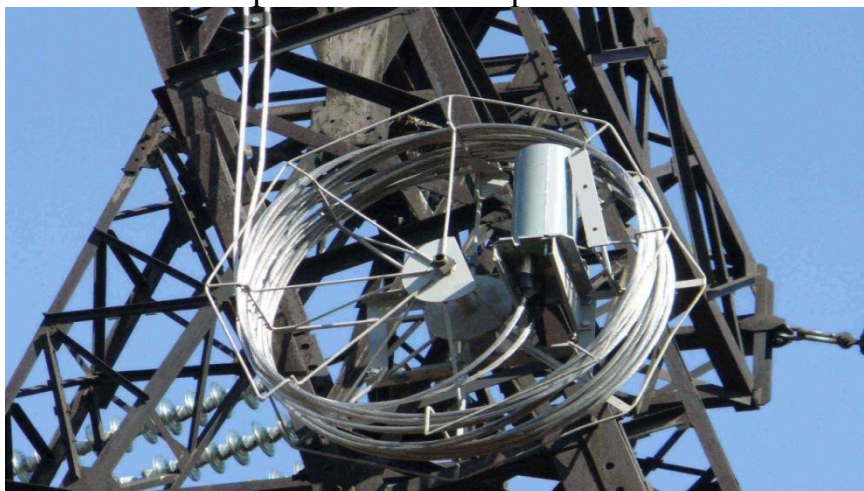
Рисунок 4.13.5 Муфта МОПГ-М с барабанами БШ на опоре ВЛ
